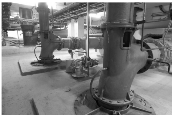
Obr. 1. Stará prací čerpadla
